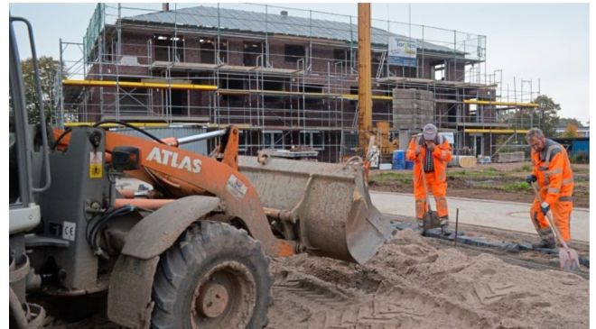
Auf der Köhlerwiese in Ganderkesee, wo eine Reihe von Mehrfamilienhäusern entsteht, ist ein Gehweg durchs künftige Wohngebiet schon gepflastert. Jetzt haben weitere Pflasterarbeiten am geplanten Spielplatz begonnen. Foto: Thomas Deeken
